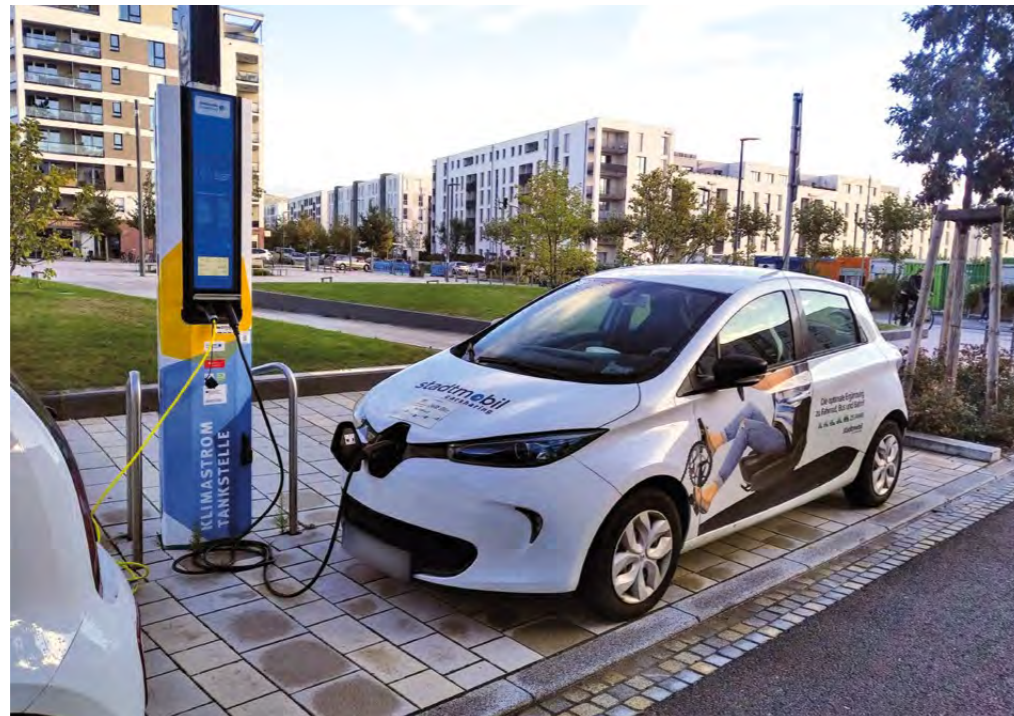
Elektro-Ladestation in der Bahnstadt
